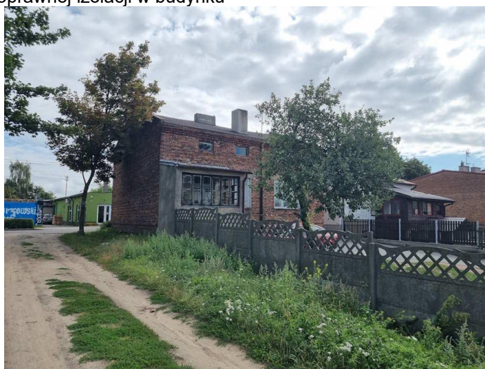
Fotografia 11 Brak poprawnej izolacji w budynku
